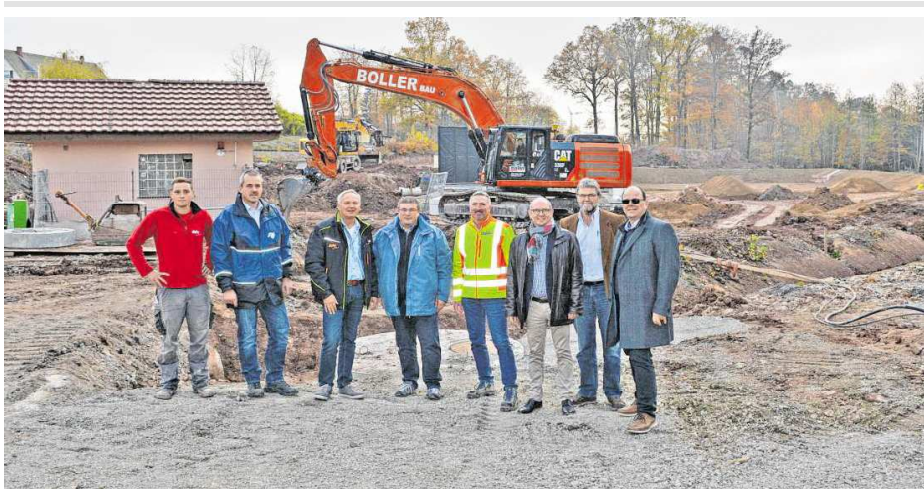
Zu einem Vor-Ort-Termin trafen sich Vertreter der Verwaltung und am Bau beteiligter Firmen.
